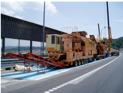
写真 1 超大型バッチプラント
